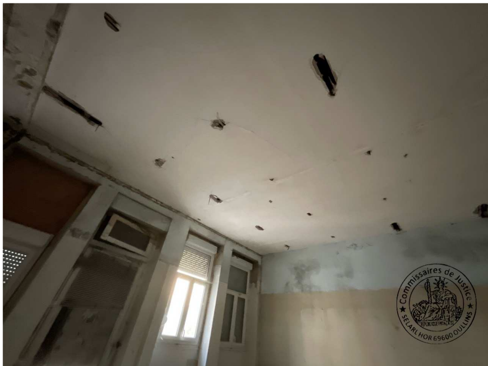
Un trou est visible au-dessus de l'ouverture du mur latéral droit, dos à la porte d'entrée.
